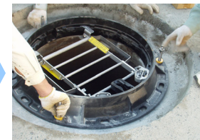
④受枠設置作業 受枠を設置し、路面の高さに合わせてレベルを調整します。
